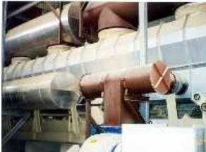
Trockner in der Trocknungsanlage
