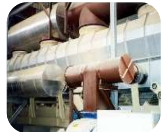
Trockner in der Trocknungsanlage
