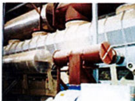
Trockner in der Trocknungsanlage
