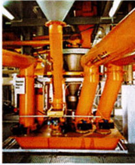
Teilansicht des Mischwerkes
